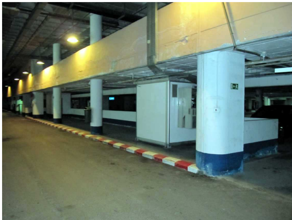
Zona 8 estado actual, anden y armario telefonía, vista desde vial.
